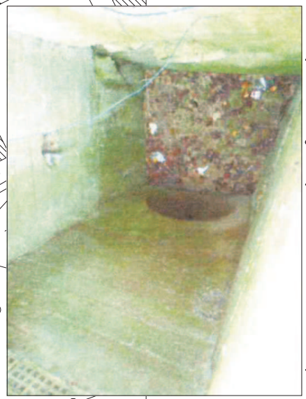
caditoia sezione tratto intubato forma circolare con \phi=100 cm in prossimità di via M. Buonarroti
